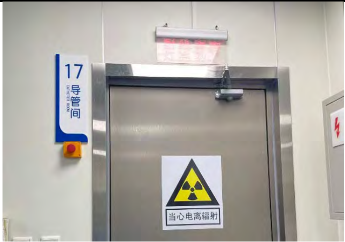
控制室防护门闭门器和警示灯
