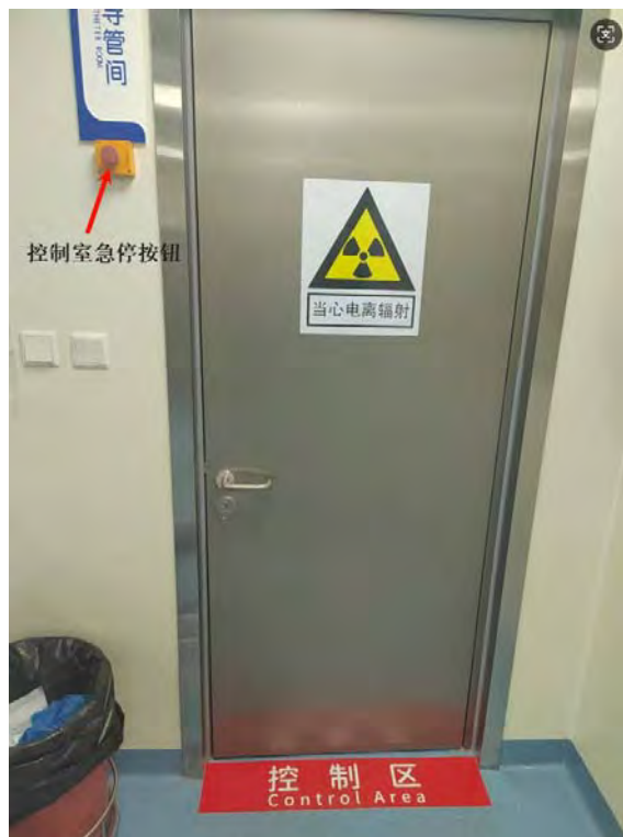
控制室急停按钮、控制区标志和防护门外电离辐射标志
